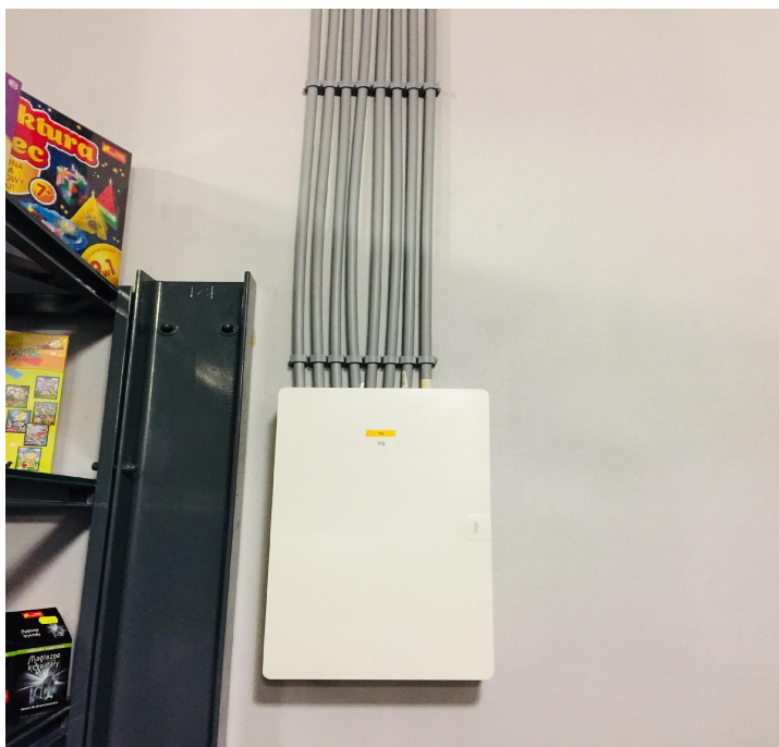
Ogólny widok rozdzielnicy TS
