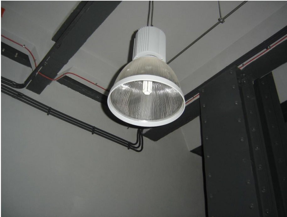
Oprawy oświetlenia ogólnego i awaryjnego
