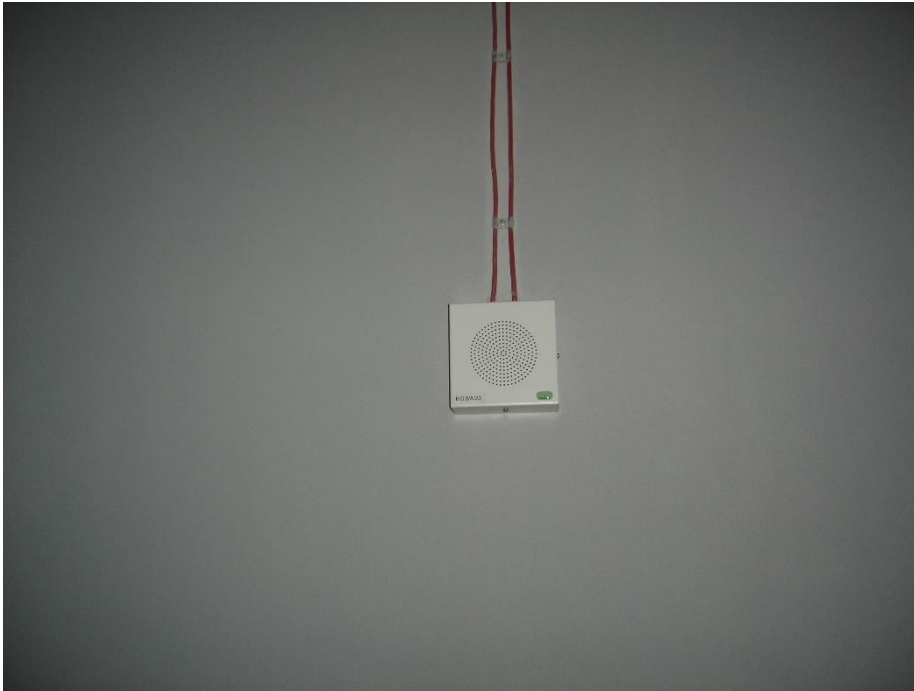
Istniejąca instalacja DSO
