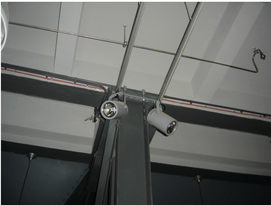
Oprawy oświetlenia ekspozycyjnego
